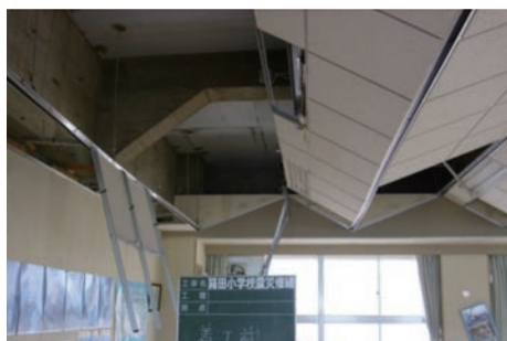
写真1. 音楽室の折れ曲がり天井の被害
