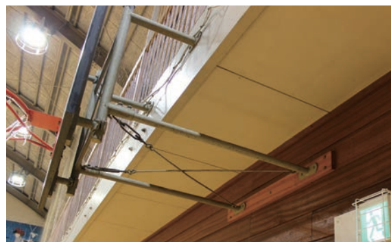
写真3. バスケットゴールの取付け部分
