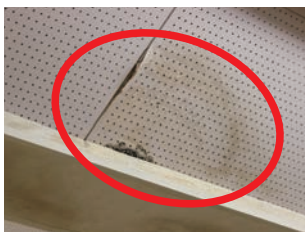
写真1. 天井材のしみ、破損
