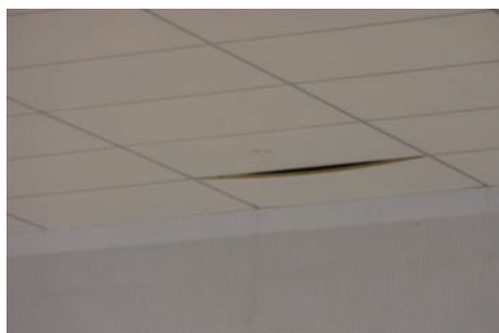
写真1. 天井材のずれ
