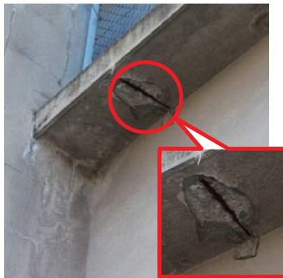
写真2. 軒裏のモルタルの剥落
