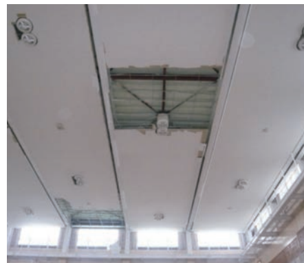
写真 1. 照明器具との取り合い部分の破損例
