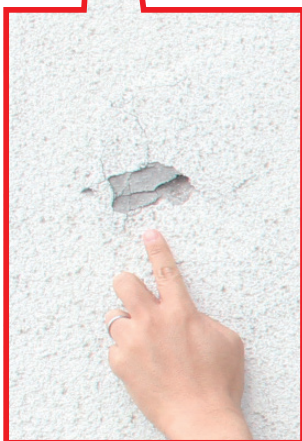
写真 3. 外壁の浮き、剥落
