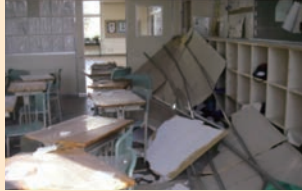
写真2. 普通教室での天井の脱落
