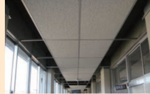
写真3. 廊下での天井の脱落
