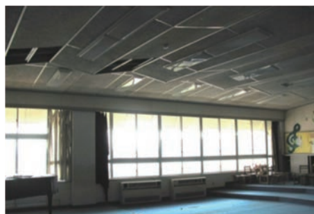
写真2. 音楽室の折れ曲がり天井の被害
