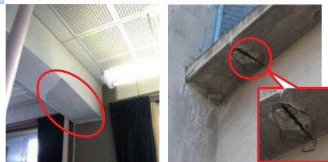
写真1. 教室梁下のモルタルの剥落
