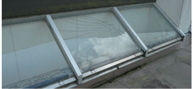
写真 1. 窓ガラスのひび割れ
