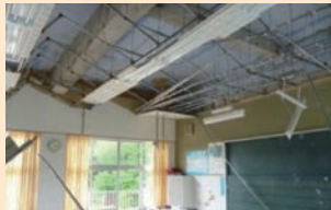
写真5. 音楽室の折れ曲がり天井の脱落
