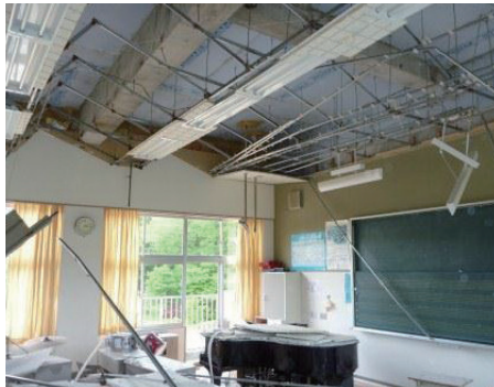
写真1. 音楽室の折れ曲がり天井の被害
