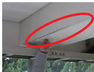
写真3. 梁の仕上げ材のひび割れ
