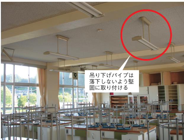
写真1. 吊り下げ形照明器具 (教室)
