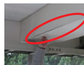
写真3. 梁の仕上げ材のひび割れ
