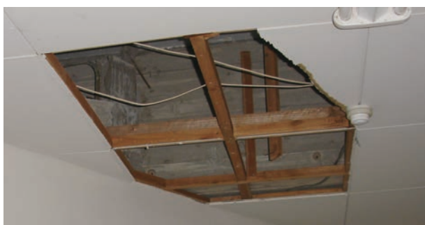
写真 1. 木下地天井の被害
