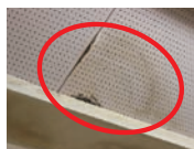
写真1. 天井材のしみ、破損
