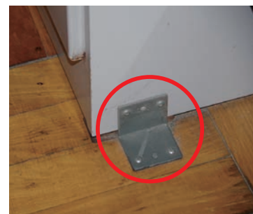
写真 2. 棚の下部を床に固定した例
