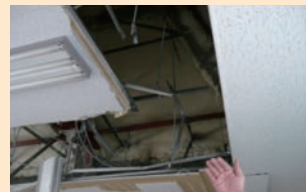
写真9. 天井裏の設備の脱落
