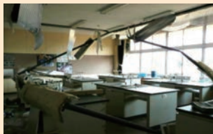
写真7. 天井裏の設備の脱落
