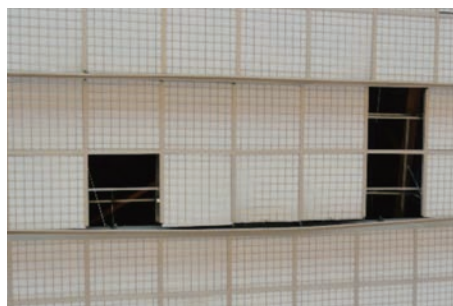
写真2. 天井材の一部脱落（下からの見上げ）
