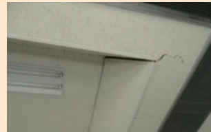
写真6. 段差部分の天井の損傷
