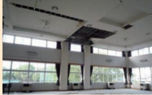
写真1. 階高の高い大空間での天井の脱落
