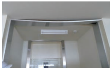
写真1. 変形した エクspansion・ジョイントカバー
