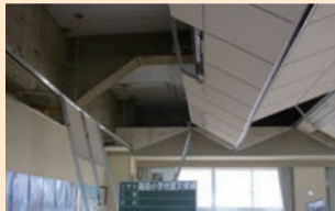
写真4. 音楽室の折れ曲がり天井の脱落
