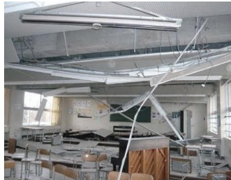
写真2. 音楽室の折れ曲がり天井の被害
