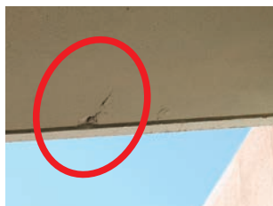
写真2. 階段裏のひび割れ
