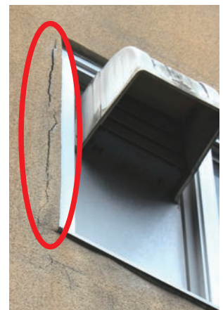
写真 6. 外壁のひび割れ
