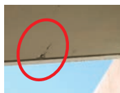
写真2. 階段裏のひび割れ
