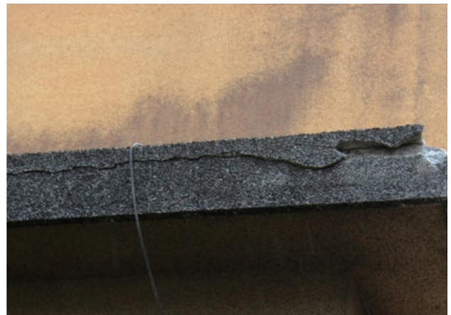
写真 2. 外壁（庇の先端部）のひび割れ、欠損
