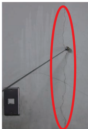
写真 4. 内壁のひび割れ
