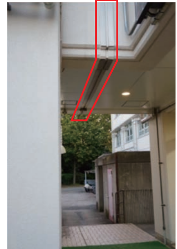
写真2. 通路の上部にある エクspansion・ジョイント
