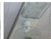
写真4. 梁のモルタルの脱落
