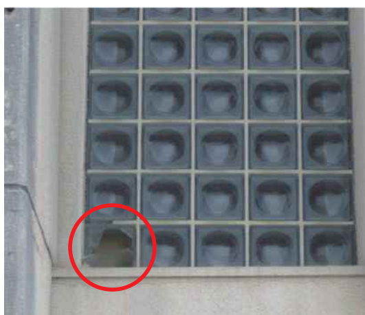
写真1. ガラスブロックの欠損
