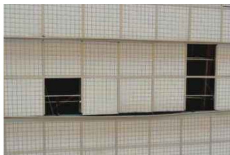
写真 2. 天井材の一部脱落（下からの見上げ）
