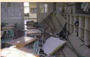
写真2. 普通教室での天井の脱落
