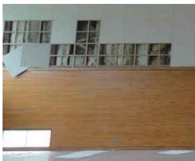
写真1. 内壁ボードの脱落
