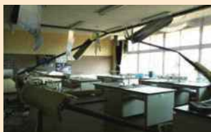
写真7. 天井裏の設備の脱落
