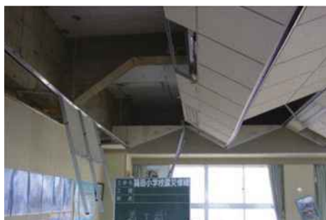
写真 1. 音楽室の折れ曲がり天井の被害
