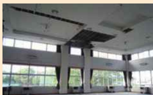
写真1. 階高の高い大空間での天井の脱落
