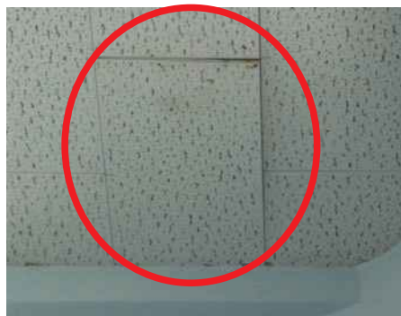
写真 2. 天井材のずれ
