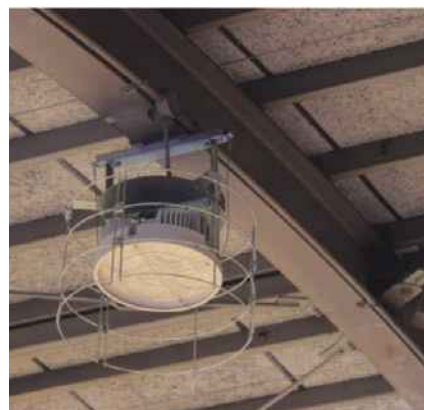
写真 1. 屋内運動場の照明器具
