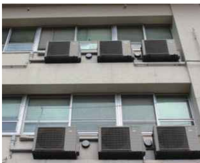
写真 1. 上階に設置された空調室外機
