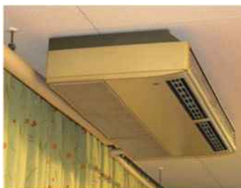
写真 2. 天吊りエアコン
