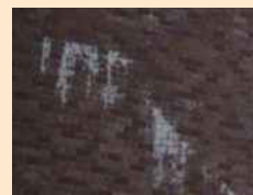
写真1. エフロレッセンス
