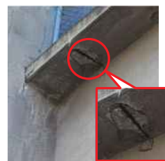
写真2. 軒裏のモルタルの剥落
