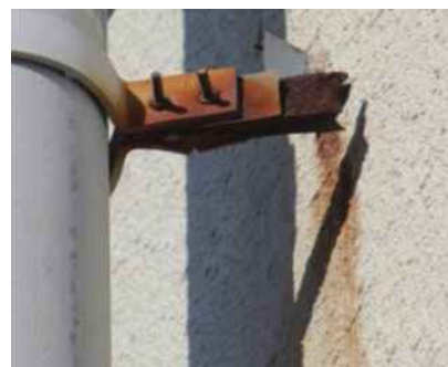
写真 1. 取付け部の腐食
