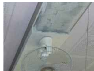
写真 4. 梁のモルタルの脱落
