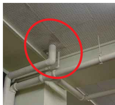
写真 1. 天井材の漏水跡
