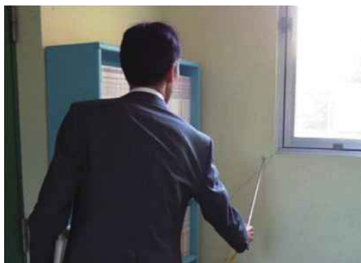
写真 1. 打診による浮きの確認
