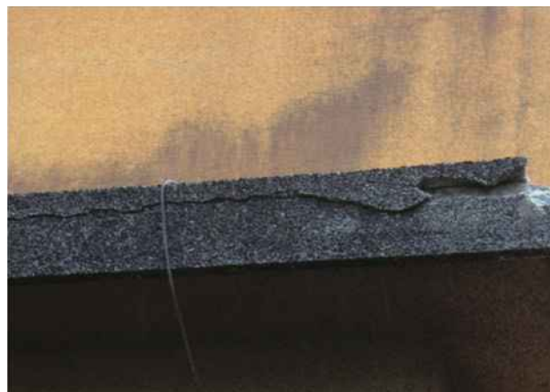
写真 2. 外壁（庇の先端部）のひび割れ、欠損
