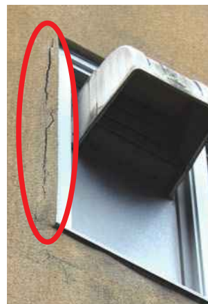
写真 6. 外壁のひび割れ
