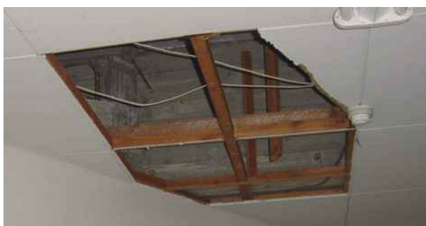
写真 1. 木下地天井の被害
