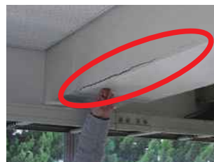
写真 3. 梁の仕上げ材のひび割れ
