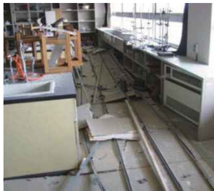
写真 2. 脱落した天井材
