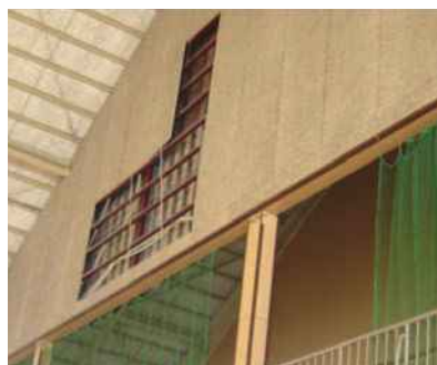
写真2. 内壁ボードの脱落
