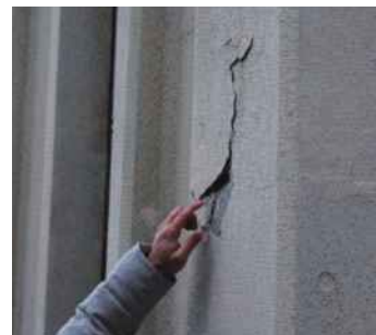
写真 1. モルタルの剥落
