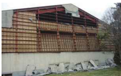
写真1. 地震によるラスモルタルの被害例
