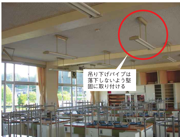
写真 1. 吊り下げ形照明器具（教室）
