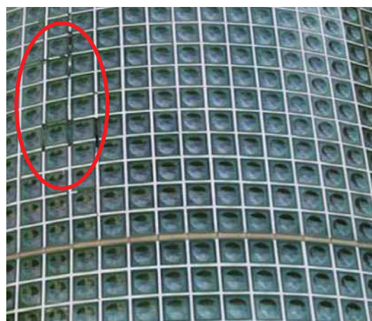
写真2. ガラスブロックの目地部の損傷
