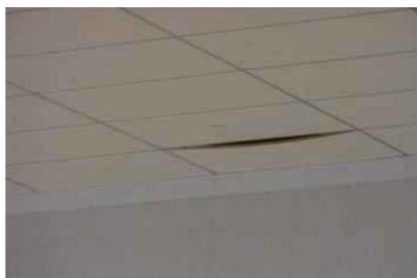
写真 1. 天井材のずれ
