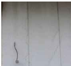
写真1. ALCパネルのひび割れ
