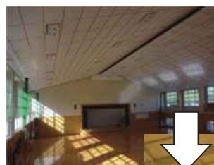
写真 1. 天井落下防止対策の事例
