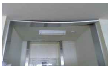
写真 1. 変形した エキスパンション・ジョイントカバー
