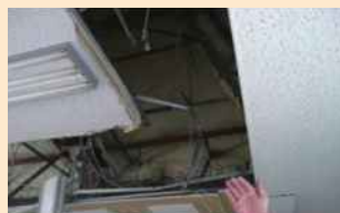
写真9. 天井裏の設備の脱落
