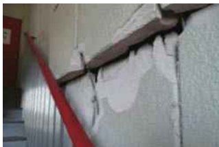
写真2. 地震によるALCパネルの被害例
