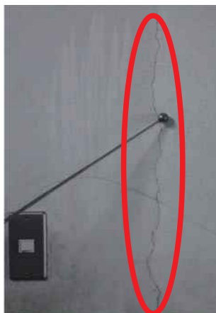
写真 4. 内壁のひび割れ
