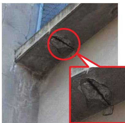
写真2. 軒裏のモルタルの剥落
