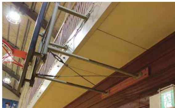
写真 3. バスケットゴールの取付け部分
