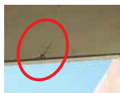
写真2. 階段裏のひび割れ
