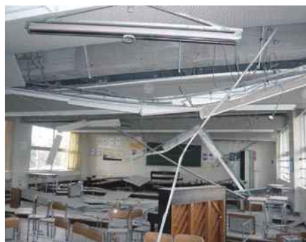
写真 2. 音楽室の折れ曲がり天井の被害
