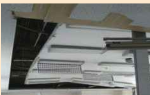
写真8. 天井裏の設備の脱落
