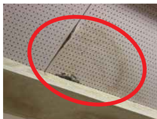
写真 1. 天井材のしみ、破損
