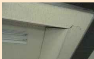
写真6. 段差部分の天井の損傷
