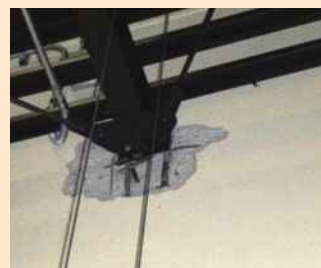
写真2. コンクリート壁との接合部の破壊
