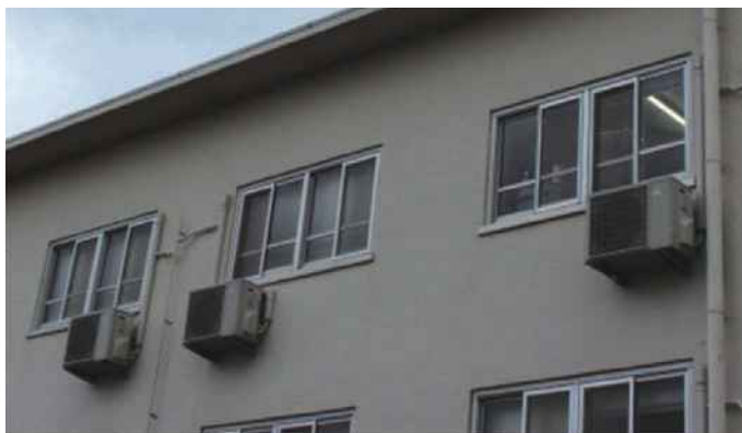
写真 1. 壁面に設置された室外機
