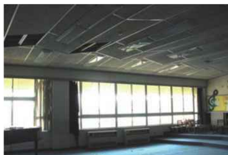
写真 2. 音楽室の折れ曲がり天井の被害
