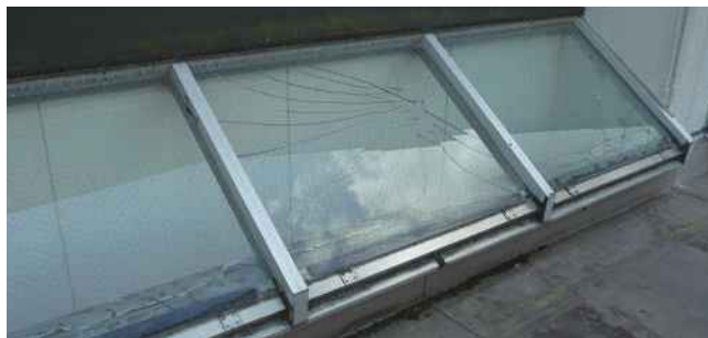
写真 1. 窓ガラスのひび割れ
