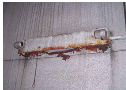
写真 1. 照明器具の腐食 3)
