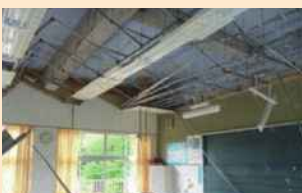
写真5. 音楽室の折れ曲がり天井の脱落
