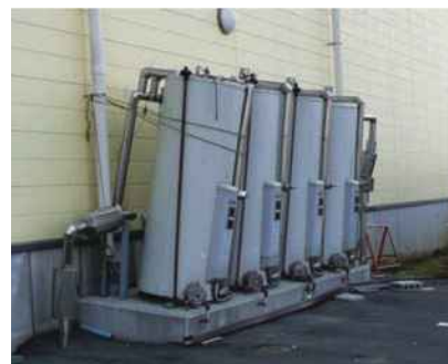
写真 3. 給湯設備の傾斜
