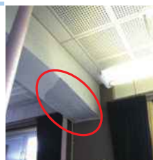
写真1. 教室梁下のモルタルの剥落
