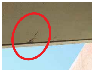
写真 2. 階段裏のひび割れ
