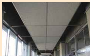
写真3. 廊下での天井の脱落
