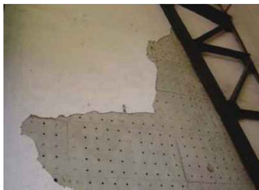
写真 2. モルタルの剥落（内壁）
