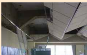
写真4. 音楽室の折れ曲がり天井の脱落
