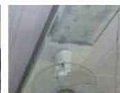
写真4. 梁のモルタルの脱落
