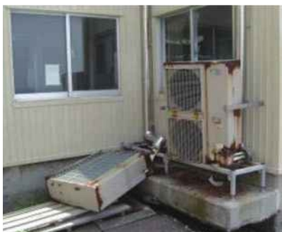
写真 2. 空調室外機の転倒
