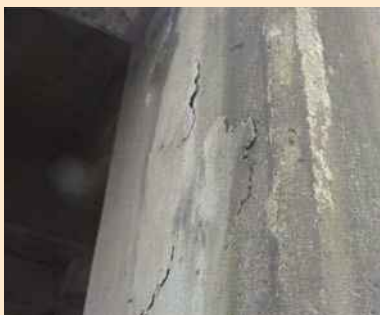
写真 3. かぶりコンクリートの浮き 13)
