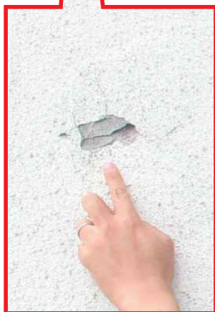
写真 3. 外壁の浮き、剥落
