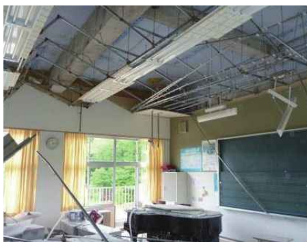
写真 1. 音楽室の折れ曲がり天井の被害
