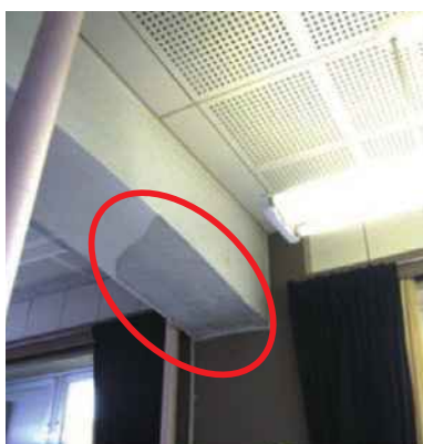
写真1. 教室梁下のモルタルの剥落
