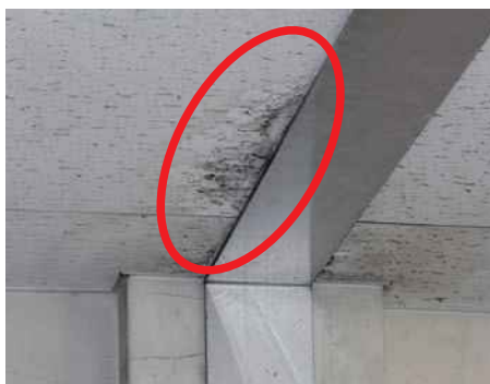
写真 1. 天井の漏水跡
