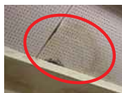
写真1. 天井材のしみ、破損
